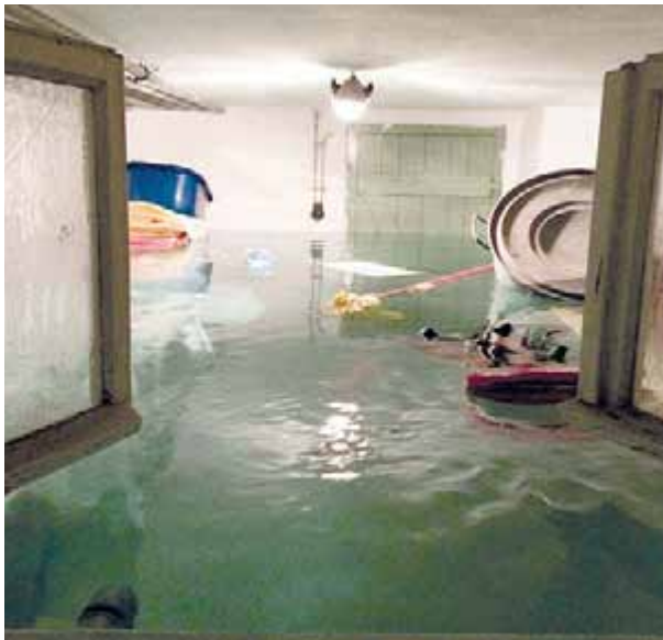
Alles nass: nach Wassereinbruch im Keller
